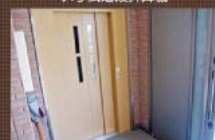
エレベーター
